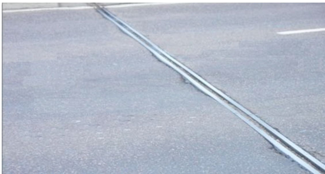
Северянинский мост, г. Москва. Состояние через 2 года эксплуатации.
